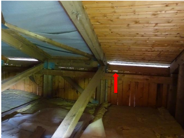
Abb. 8: Spalten zwischen den Holzbalken des Dachstuhls (roter Pfeil)
