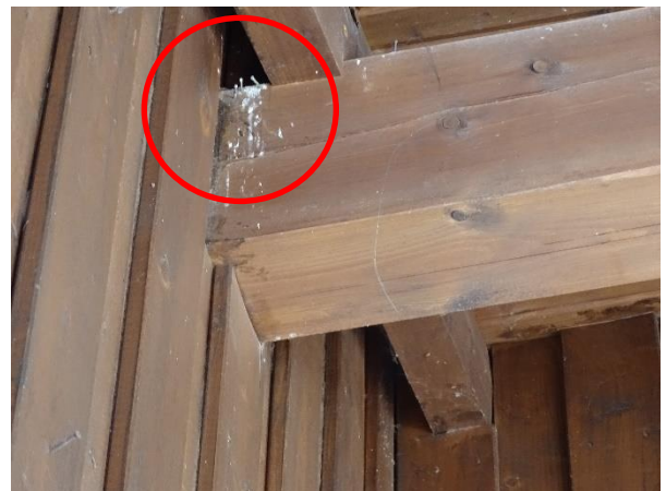
Abb. 11: Vogelkot im Traufbereich des Bestandsgebäudes
