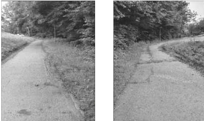
Abb. 2: schadhafter Wegabschnitt Bruch – Oberweissach
