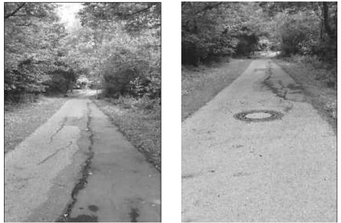
Abb. 4: schadhafter Wegabschnitt Oberweissach - Aichholzhof
